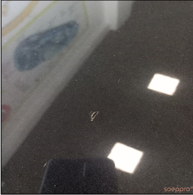
On kaput kaplamasında deformeler var ve hafif gocuk var
