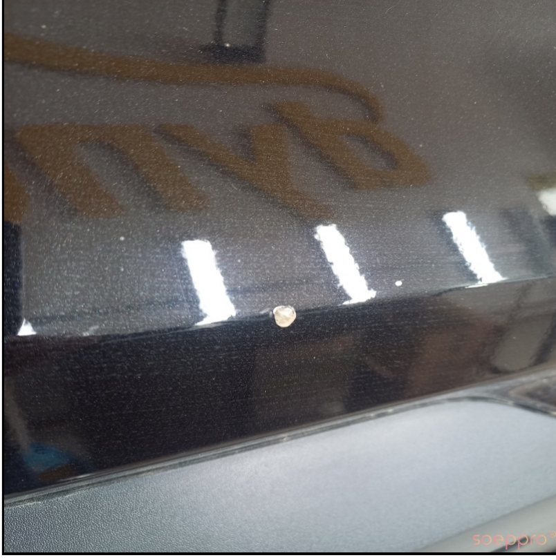
Sag on kapi kaplamada deforme var
