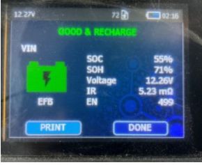
Elektrik donanımı/Pano, Akü > Test Sonucu
